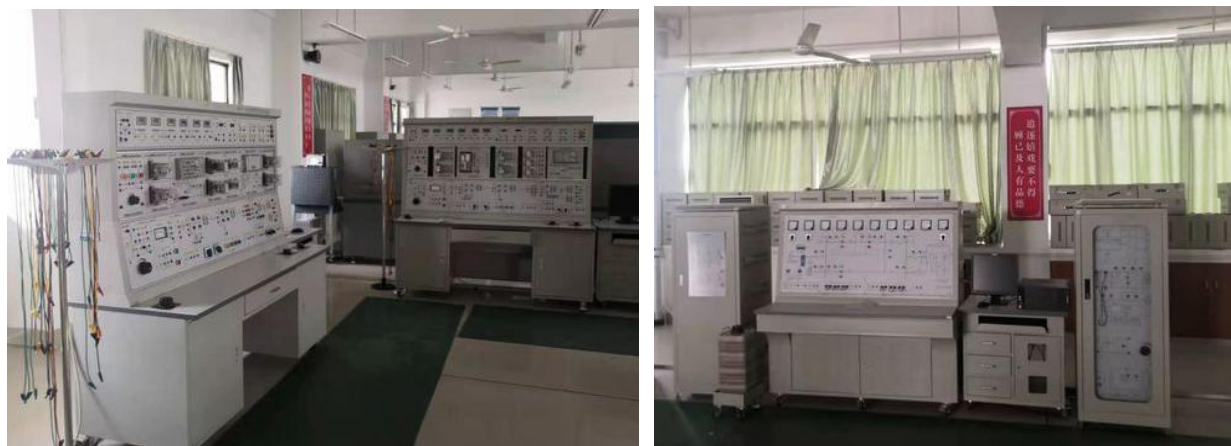
现代电力系统实训室
