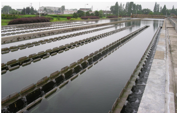
市政给排水系统的建设和运行管理
